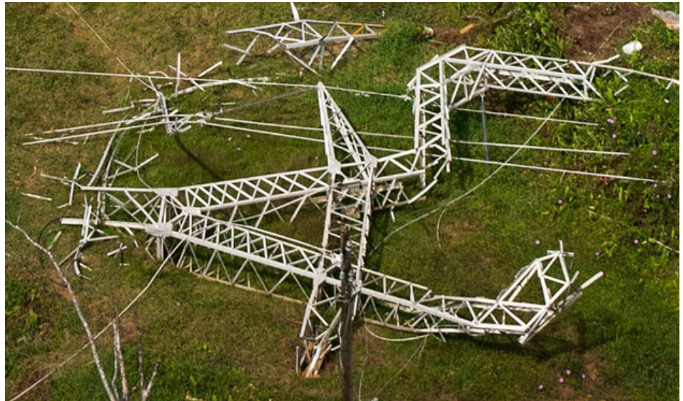
Torre de transmisión destruida en Puerto Rico después del huracán María [1]
